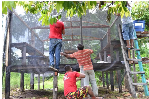
Figura 5. Viveiro educativo sendo construído por comunitários na comunidade Nova Betânia, Reserva Amanã. Foto: Claudia Santos, 2015.
